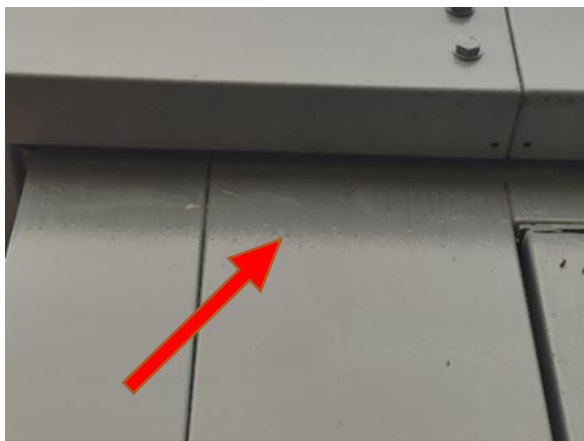
Dažų nuovarovos, dažymo defektas
